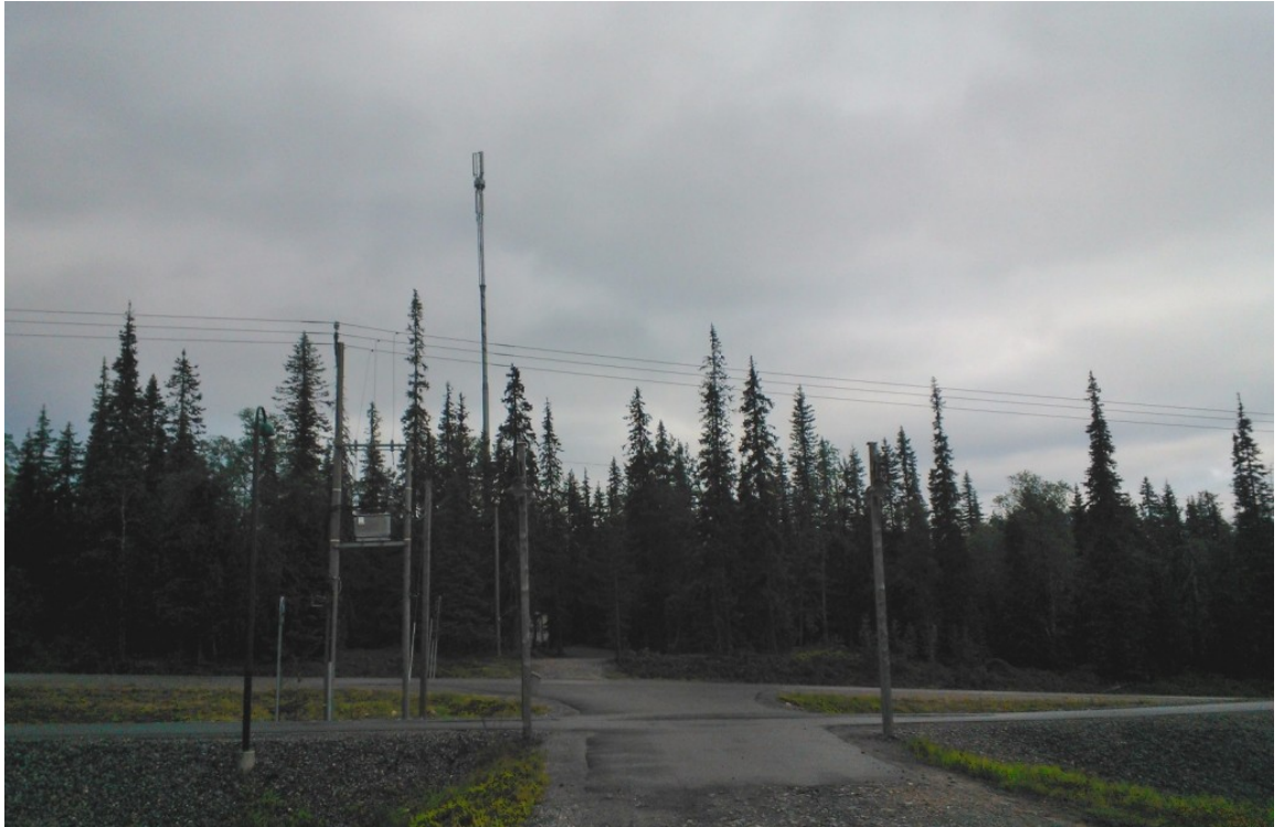
Kuva 24. Matkapuhelintukiasema Kellokkaan pihalta kaava-alueelle päin katsottuna. Tukiaseman korkeus on n. 30 m, mutta harmaan värityksen ansiosta sen havaitseminen etenkin pilvisellä säällä on kauempaa tarkasteluna vaikeaa.
